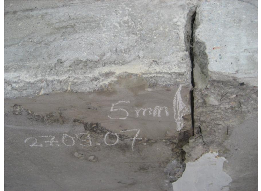
Plaisas laiduma konstrukcijas stieptajā zonā
