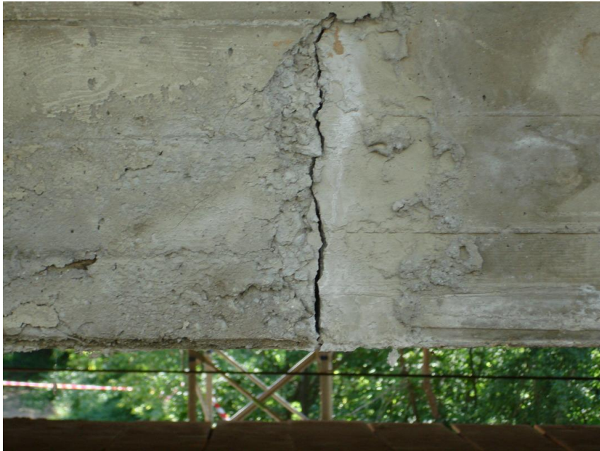
Plaisas laiduma konstrukcijas stieptajā zonā
