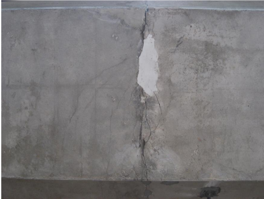
Plaisas laiduma konstrukcijas stieptajā zonā
