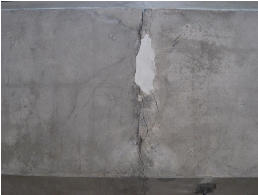
Plaisas laiduma konstrukcijas stieptajā zonā
