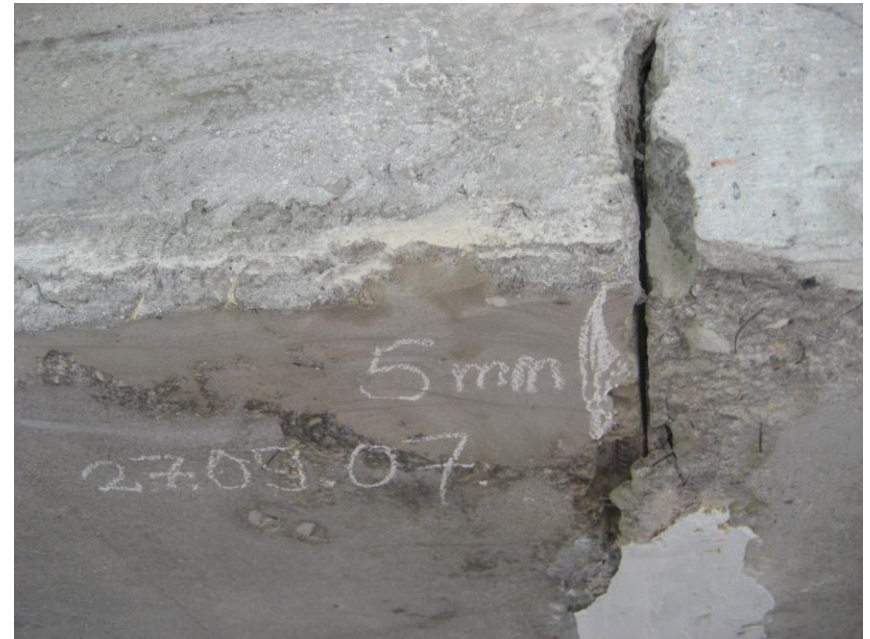
Plaisas laiduma konstrukcijas stieptajā zonā
