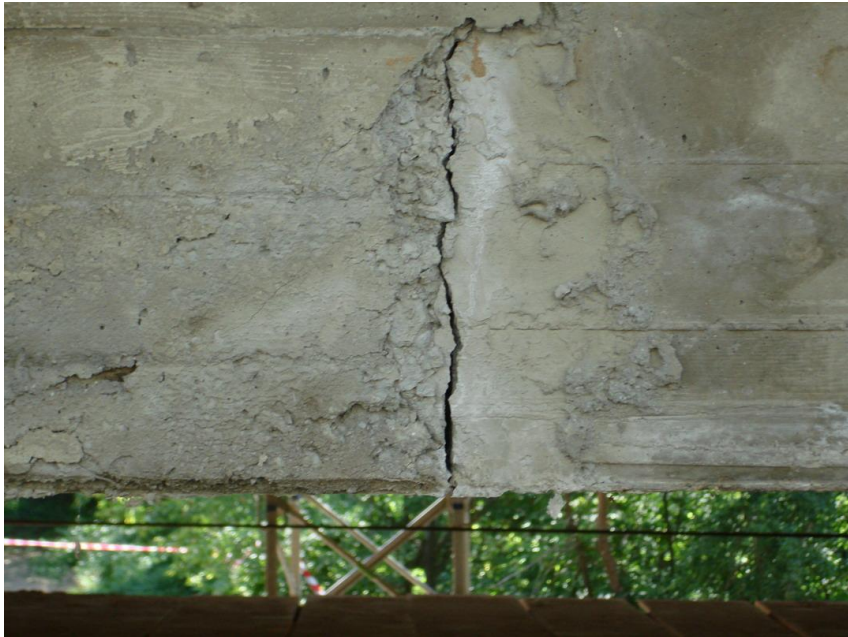
Plaisas laiduma konstrukcijas stieptajā zonā
