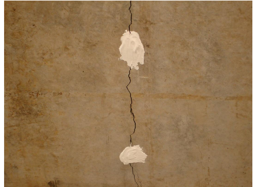
Ģipša uztriepes laiduma konstrukcijas stieptajā zonā
